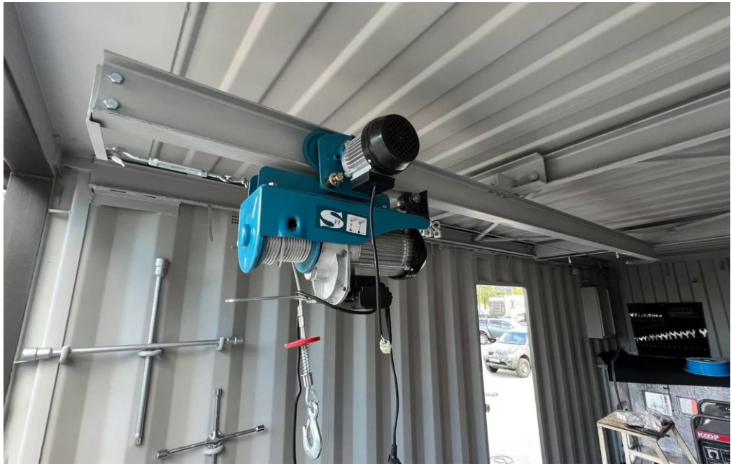
Рисунок 3 – Кран балка з електричним тельфером
