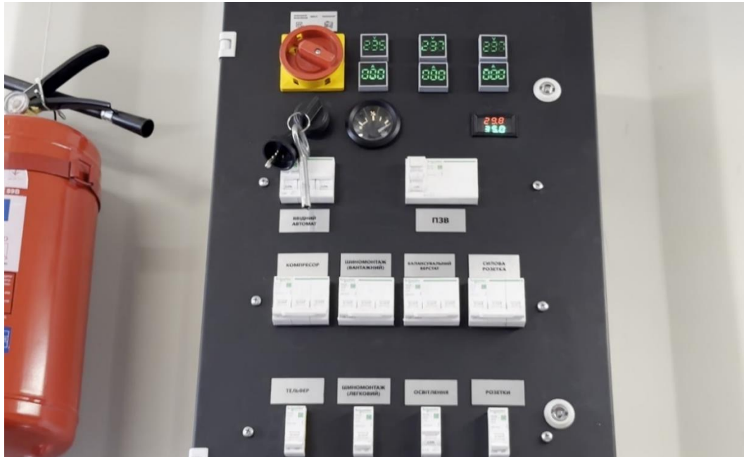
Рисунок 5 – Зовнішній вигляд щитка живлення
